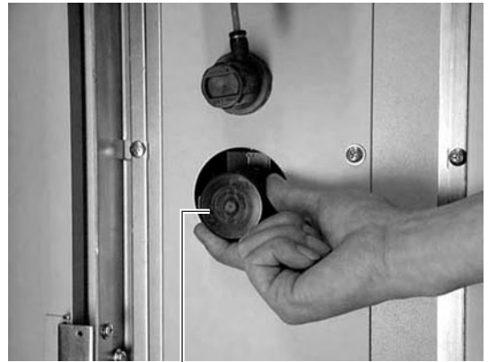
供气 / 排气开关
