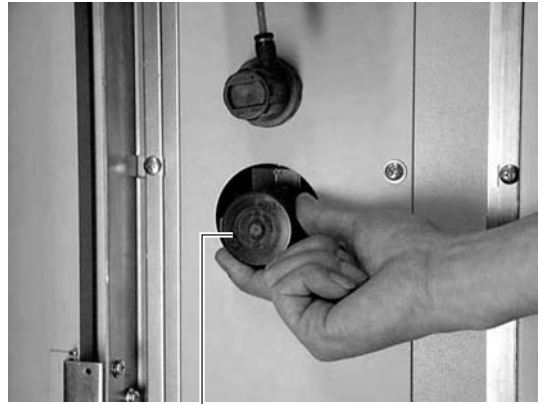
供气 / 排气开关
